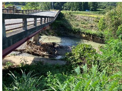
損壊した上屋敷橋
